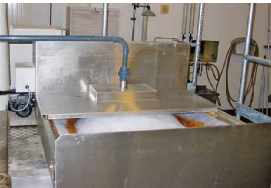
Schlammwässerung in der neuen AVRA in Sumiswald
