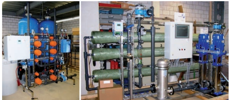
Bild 2: Enthärtungsanlage (links) und Umkehrosmoseanlage (rechts) mit einer Permeatleistung von 10 m 3 /h.
