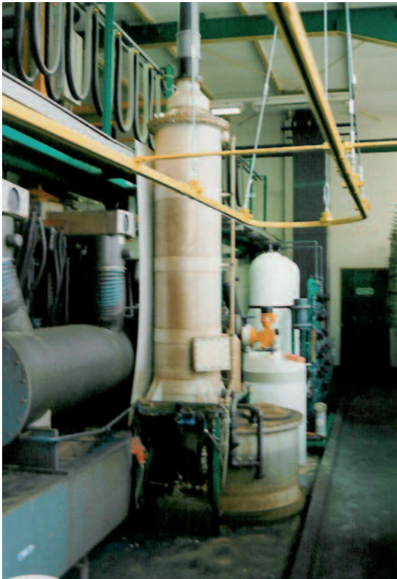
Diese Recyclinganlage wurde 1991 in Betrieb genommen.
