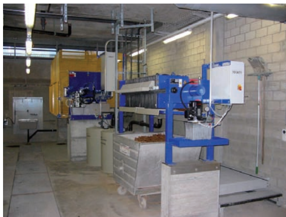
Schlammwässerung mittels Filterpressen
