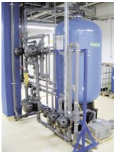
Nachfiltration (10 m 3 /h) mittels Mehrschichtfilter
