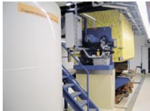
Chargenbehandlung (24 m 3 Kapazität) und vollautomatische Filterpresse
